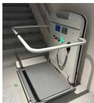
昇降機 駐車場エリアから1Fへ
